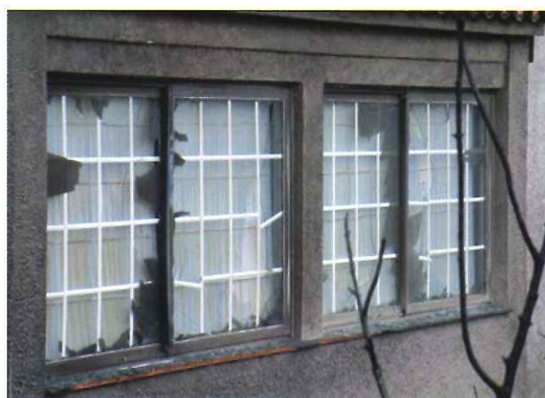
Fig 15. Efecto del fuego sobre vidrios y cerramientos de las aberturas exteriores.
