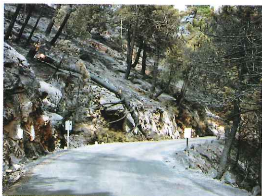
Efectos del incendio en las fajas conlindantes al eje de la carretera desde el Puerto de las Palomas al poblado de Vadillo. Se pueden apreciar muestras (fracturas y estallamientos de algunos fustes) de las extremas condiciones energéticas derivadas de la combustión.
