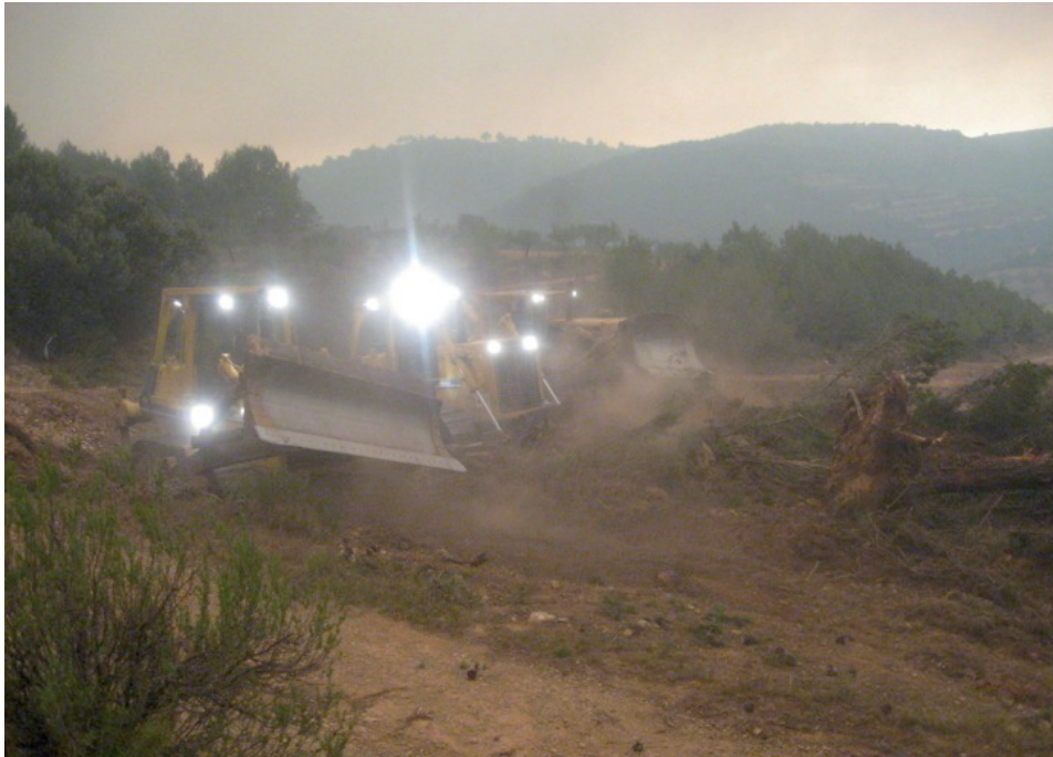
Figura 87 Ataque indirecto con tractores de cadenas avanzando paralelamente sobre cortafuegos existente. Cortes de Pallars (Valencia) Foto: Javier García.
