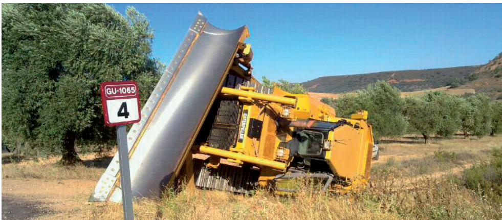
Figura 130 Vuelco de bulldozer al bajarlo del semirremolque góndola en terreno con ligera pendiente transversal y terreno suelto. Foto: Daniel Melara.
