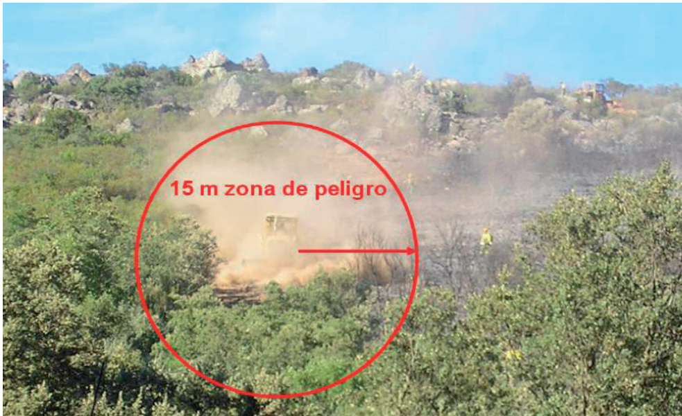
Figura 136 Zona de peligro en el radio de acción del tractor. Trabajo de un tractor en línea de máxima pendiente. Retuerta del Bullaque (Ciudad Real). Foto: autor.
