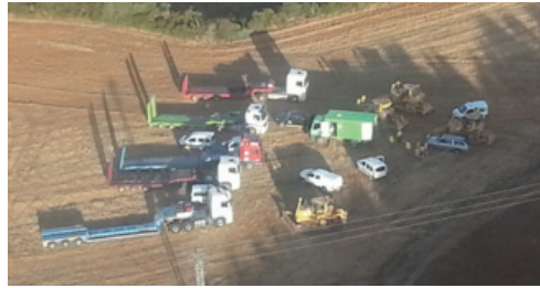
Figura 118 Ejemplo de zona de descarga, repostaje y mantenimiento de equipos de maquinaria pesada. Cogolludo (Guadalajara). Foto: Autor.
