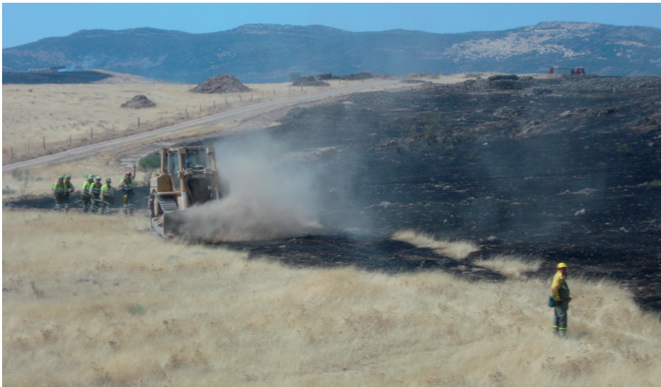
Figura 89 liquidación de perímetros con tractor de cadenas. Cabezarubias del Puerto (Ciudad Real) Foto: Autor.
